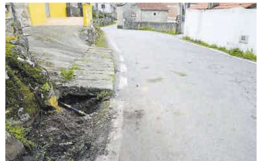
Carretera de Nerga, donde se detectó la avería en la red.
